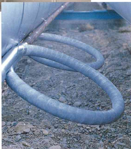
▲スチーム管ベント部
