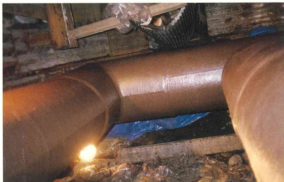
▲地下埋設配管
