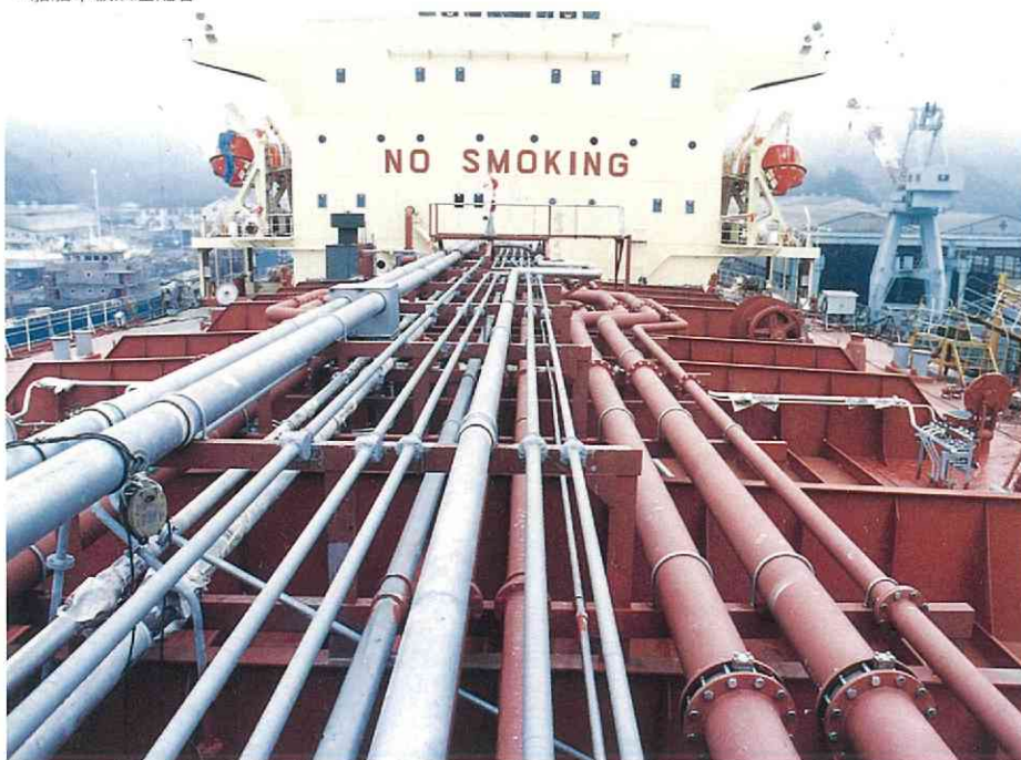
▼船舶甲板油圧配管
