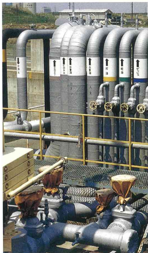
▲油槽所の栈橋配管
